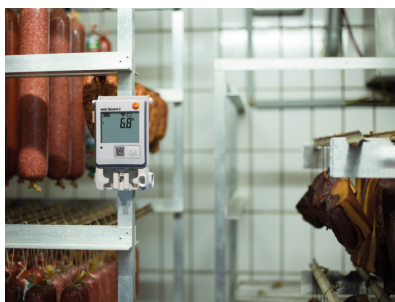
Kühlraum-Überwachung beim Metzger (testo Saveris 2-T2 mit externem NTC-Fühler mit Türkontakt)
