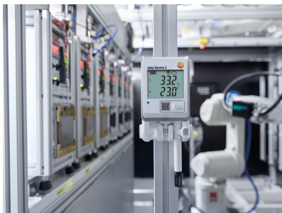
Serverraum-Überwachung in der Industrie (testo Saveris 2-T1)
