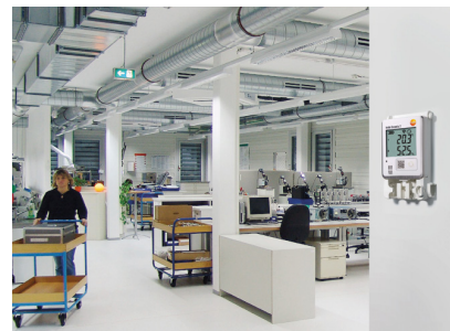
Schimmelprävention – Raumklima (testo Saveris 2-T1)
